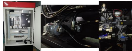
Tủ điện lắp ráp tại xưởng
