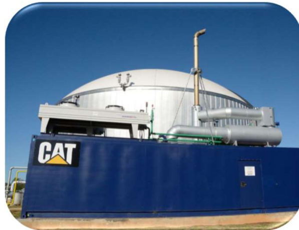
Hệ thống Biogas
