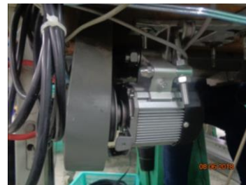
Động cơ servo đã lắp đặt tại nhà máy
